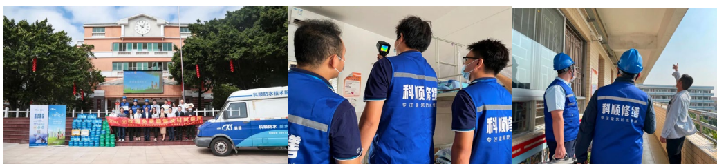
项目启动及校园渗漏情况勘察
